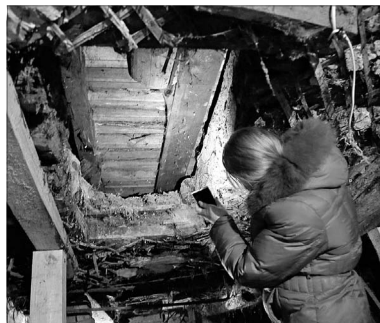
■ Через сквозную дыру из подвала виден настеленный пол в квартире первого этажа
