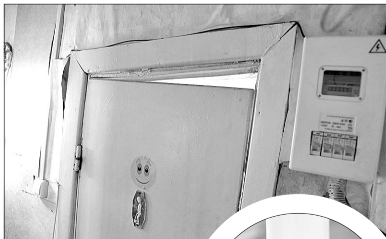
■ Щель при закрытой двери наглядно показывает, как повело стены и пол в квартире, поэтому вся мебель стоит вот на таких подставках
