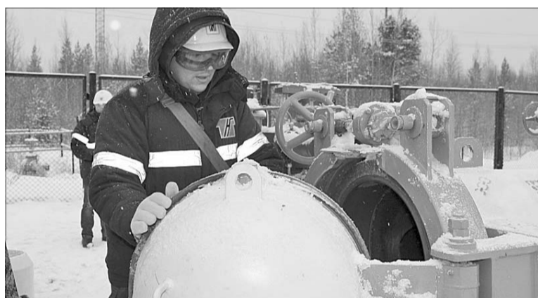
■ Перед началом очистных работ открывается отсек камеры пуска-приема
