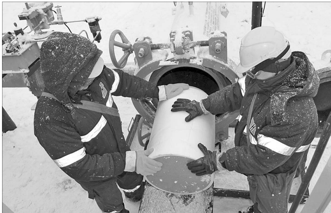
■ Вот такой скребок запускается в газовую трубу для очистки ее от конденсата
