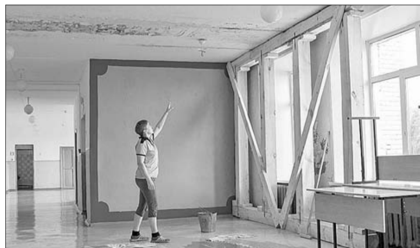
■ Третий этаж чилинской школы – самый опасный. Во время дождя здесь стоят ведра, тазики, ванны. Вода затекает даже в люстры. От обрушения стены и потолок спасают вот такие подпорки
