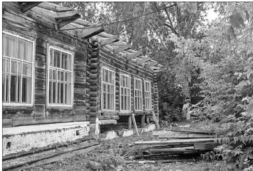
■ Строители разобрали кровлю и убрали гнилые венцы. В деревянном здании текинской школы 1965 года постройки ни разу не проводился капитальный ремонт
