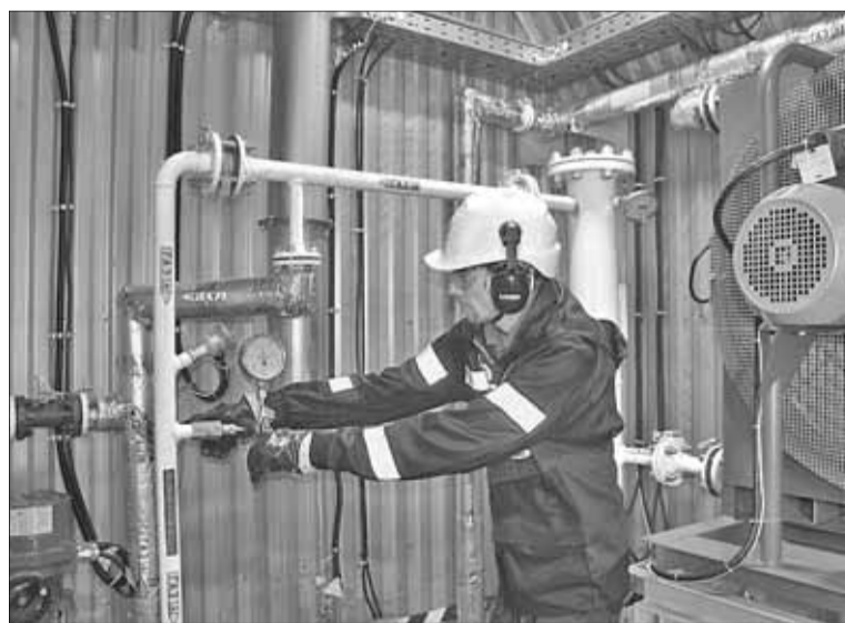
■ Вакуумная компрессорная станция
